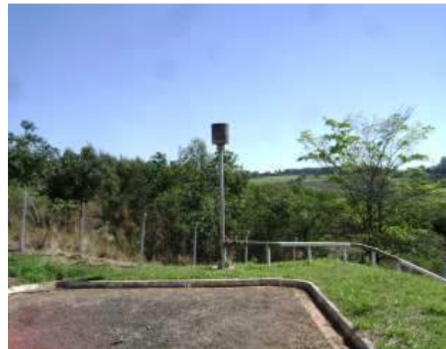
Figura 04: Flare para queima e transformação de metano em dióxido de carbono na ETE de Echaporã.
